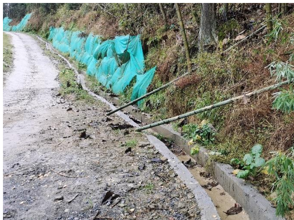
15-20#风机道路排水沟
