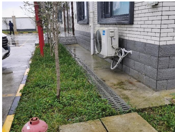
升压站排水绿化
