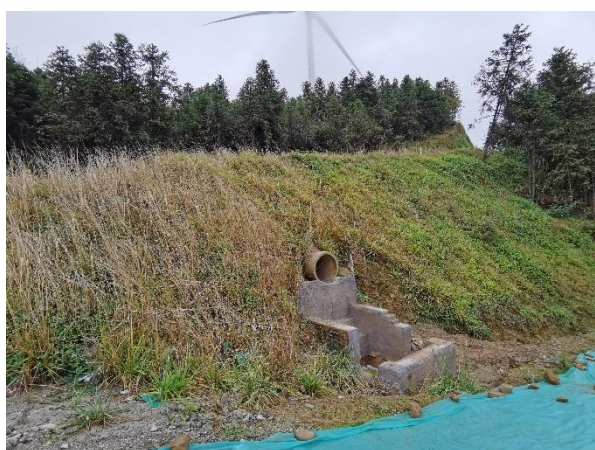
10#风机道路排水涵管
