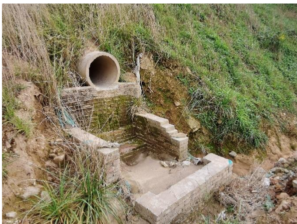
11、13#风机道路路口排水涵管
