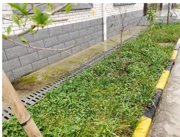
升压站排水绿化
