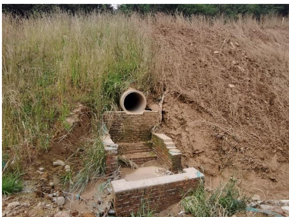
11#、13#风机道路路口排水涵管
