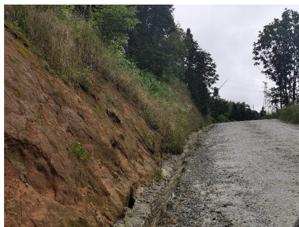
15~20#风机道路临时排水沟
