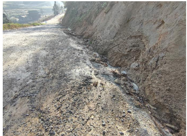
15~20#风机道路临时排水沟
